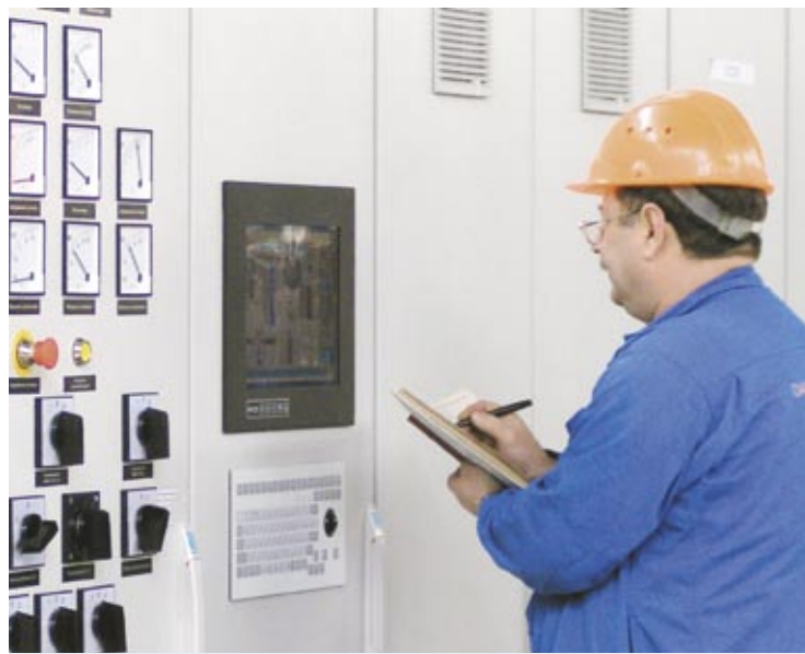
На гидростанциях всегда осуществлялись мониторинг и диагностика оборудования, но отдельной службы не было.
