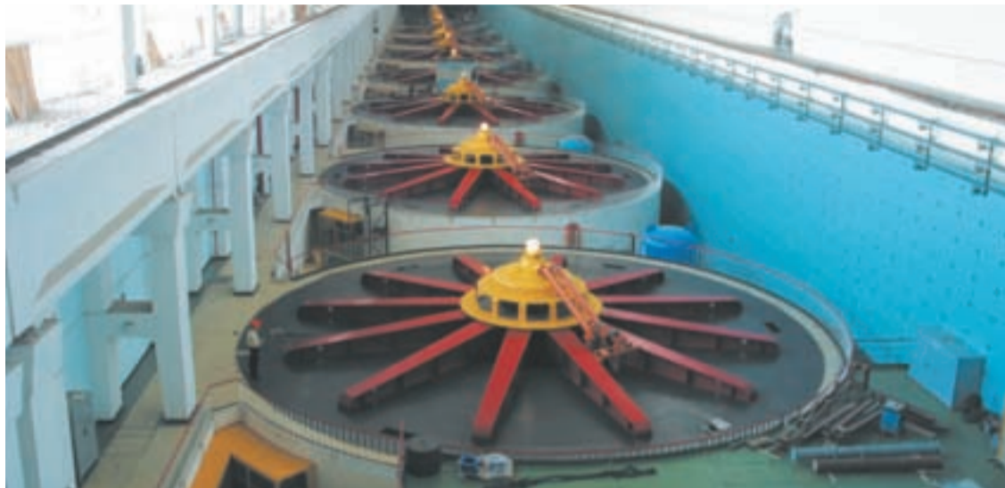
На Воткинской ГЭС за счет оптимизации режимов работы вспомогательных систем, модернизации автоматики и системы освещения уже в 2010 году можно получить экономию до 2,1 млн кВт·ч.
